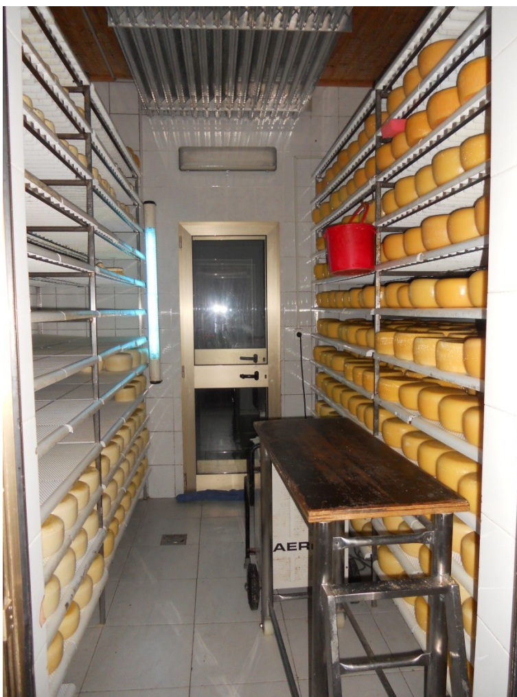
Slika 15. Sustav stropnog mirnog hlađenja u prostoriji za zrenje sira(izvor: S. Kalit)
